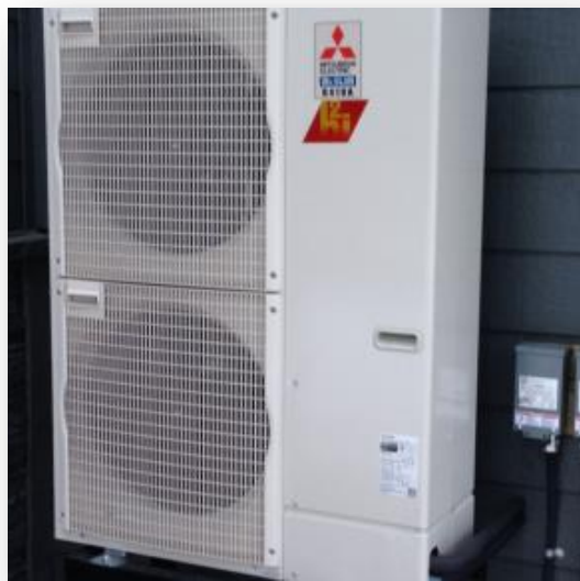
Figure 3 : Pompe à chaleur
