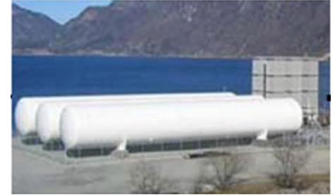
LNG Storage and Vaporization
